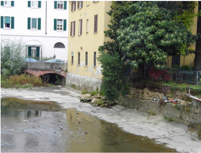
Erosione argine di via S. Gerardo dei Tintori
