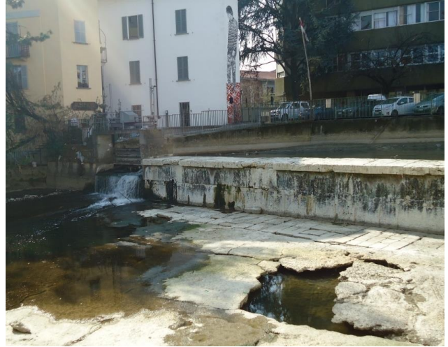
Erosione sotto la traversa del Mulino Colombo
