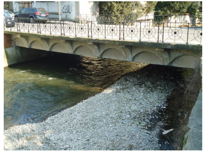
Detriti accumulati dal Lambretto sotto il ponte di via Annoni
